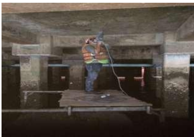
NÚT BÊ TÔNG GÀM CẦU CẢNG
