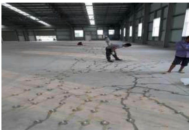
NÚT BÊ TÔNG NỀN NHÀ XƯỞNG
