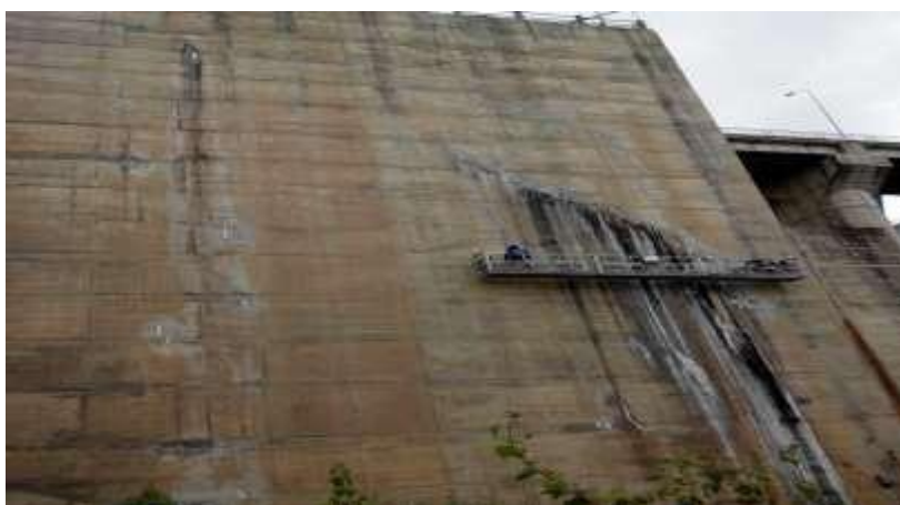
NÚT BÊ TÔNG ĐẬP THỦY ĐIỆN
