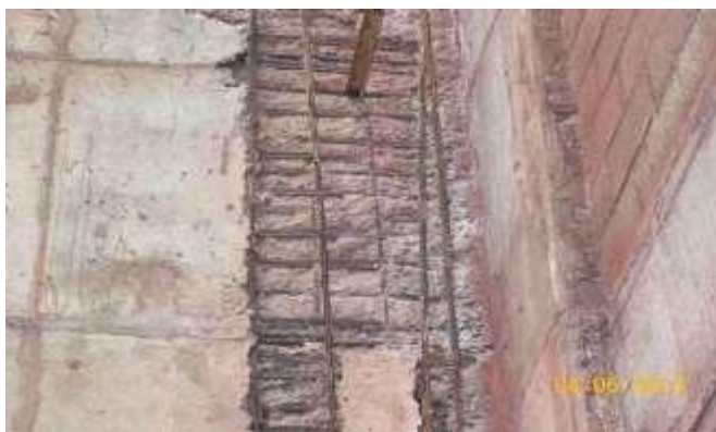
THÉP BỊ GỈ TẠI NHÀ MÁY PHÂN BÓN
